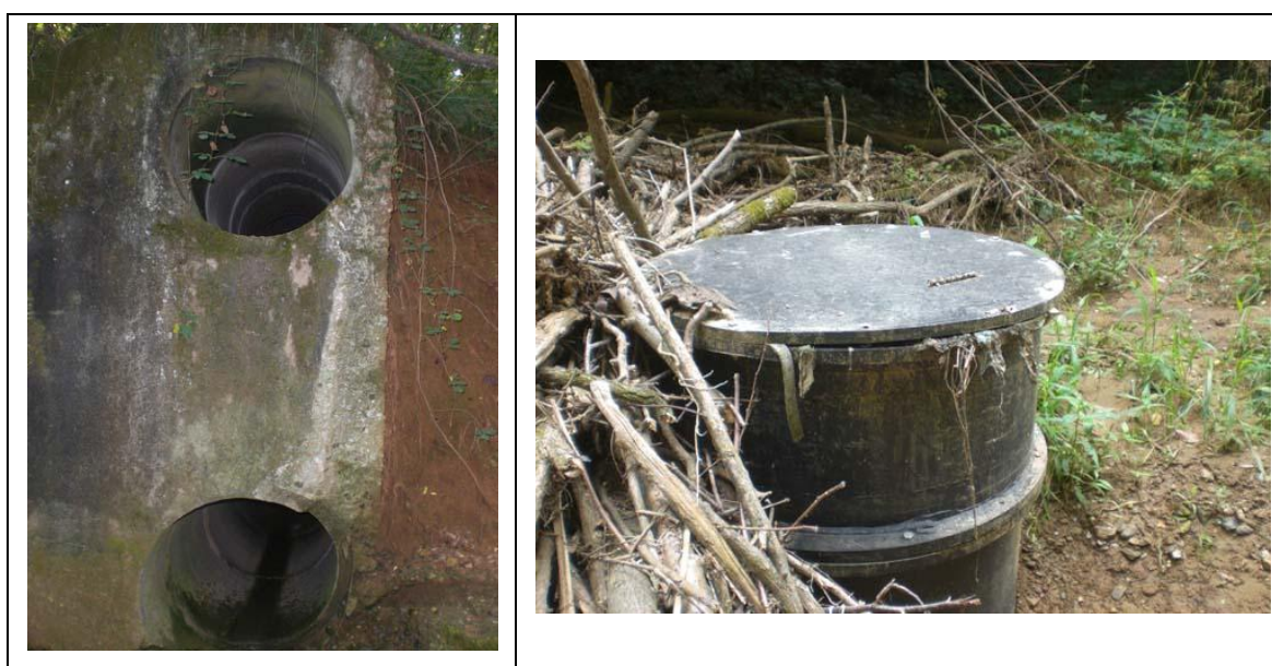
FIGURA 2.11 SCOLMATORE COMUNALE IN SPONDA SINISTRA IDROGRAFICA (A SINISTRA); TORRETTA D’ISPEZIONE DEL COLLETTORE CONSORTILE CON EVIDENTI SEGNI DI FUORIUSCITA DI LIQUAMI DAL CHIUSINO (A DESTRA) (ARCHIVIO CSBA, 2009).
